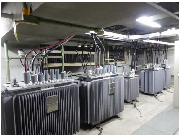
地階の受電室
