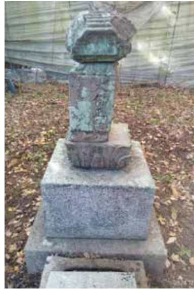
図63 き損している墓石 (墓所エリア)
