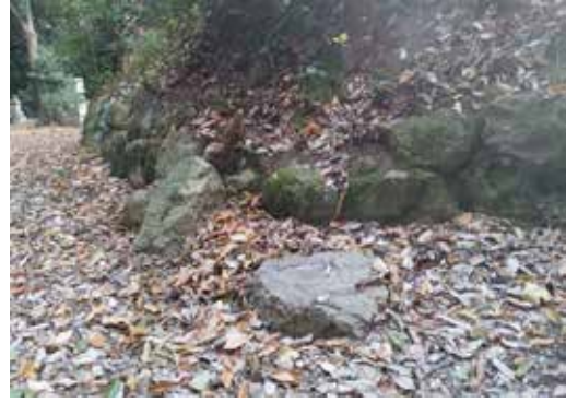
図61 義家墓石垣崩落および埋没状況 (墓所エリア)
