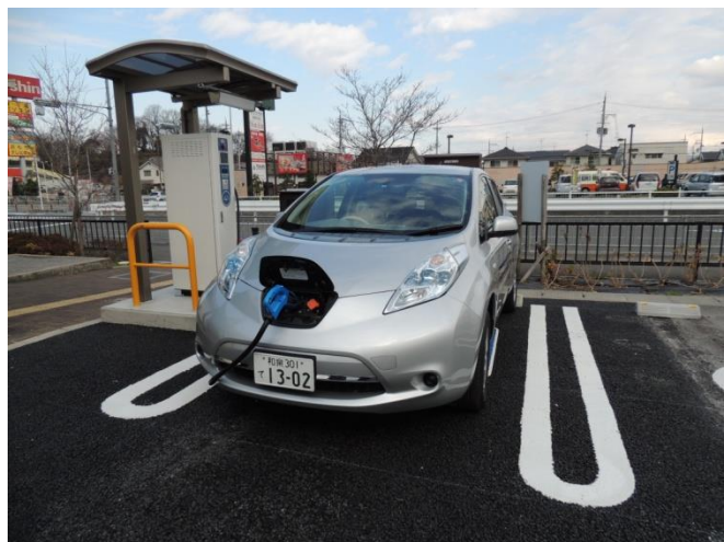
電気自動車の急速充電設備(道の駅しらとりの郷・羽曳野)
