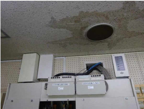
屋上からの漏水跡
