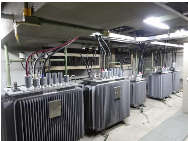
地階の受電室
