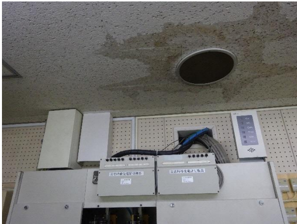
屋上からの漏水跡
