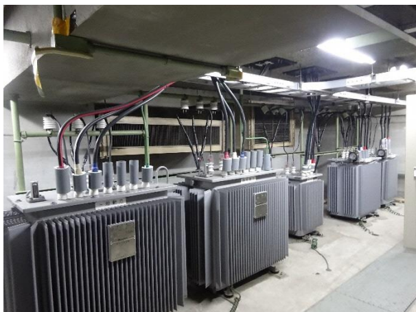
地階の受電室
