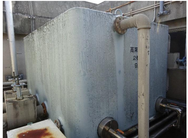
設備機器、設備配管の劣化
