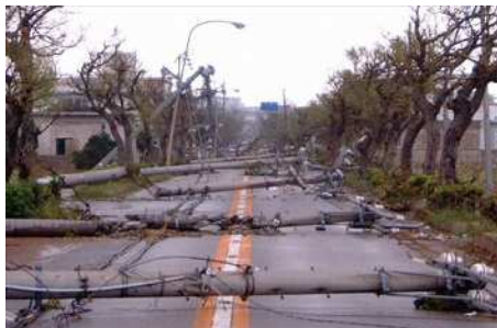
図 2.1 災害時の救援活動を妨げる電柱（出典：国土交通省 HP）
