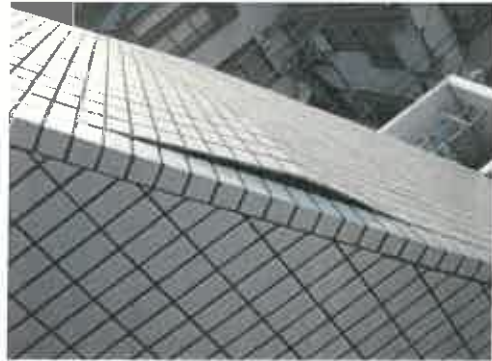
外壁に浮きが生じている
