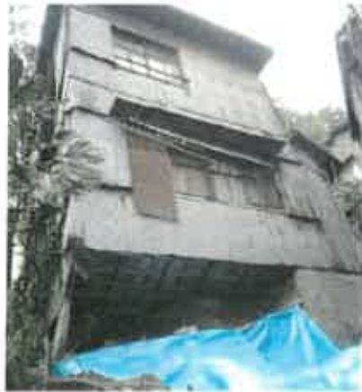
基礎が大きく欠損している (台風の影響による被害)
