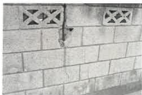
塀に大きなひび割れが生じている
