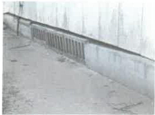
基礎が沈下し破損している
