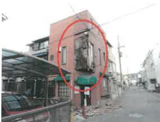
外壁が破損している
