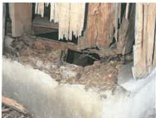
蟻害が発生し欠損している
