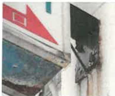
支持部分に著しい腐食が発生している
