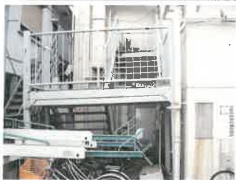
屋外階段が傾斜している
