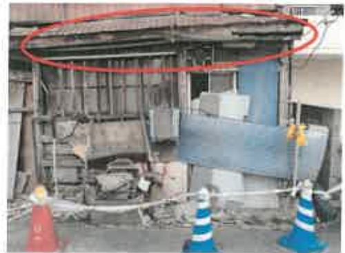
軒に不陸、剥離が生じている
