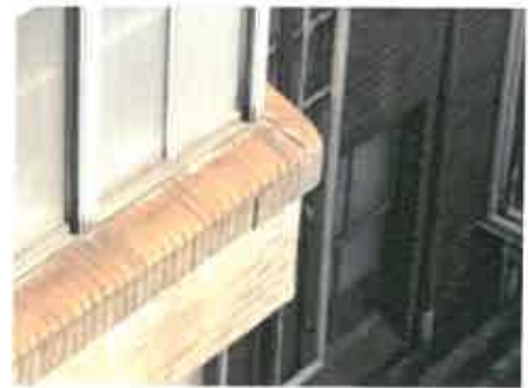
外壁に浮きが生じている
