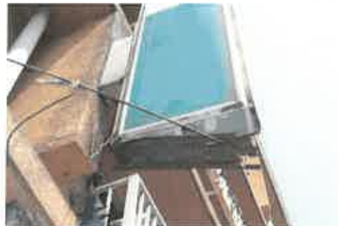
底板に腐食が発生している
