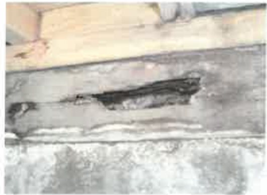
土台に蟻害が発生している
