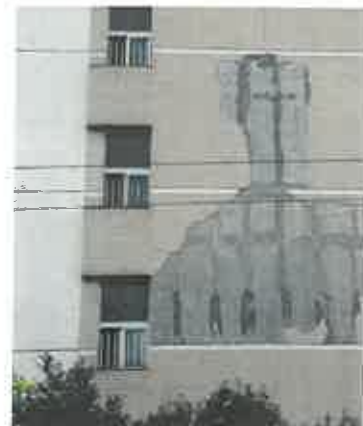
外壁に脱落が生じている
