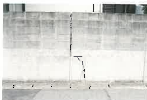
塀に大きなひび割れが生じている
