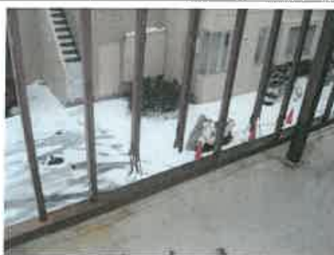
バルコニーの手すりが腐食している
