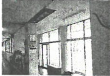
落下した天井の石膏ボード
