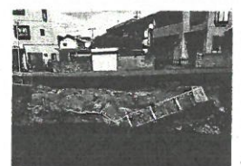
東除川護岸崩落
