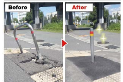
▲バリアカーの破損
