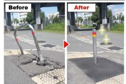
▲バリアカーの破損
